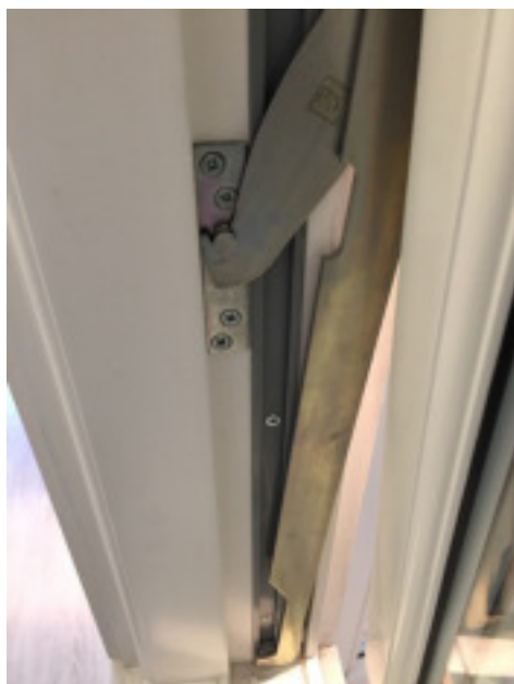
Låst fönsterbåge i vädringsläge
